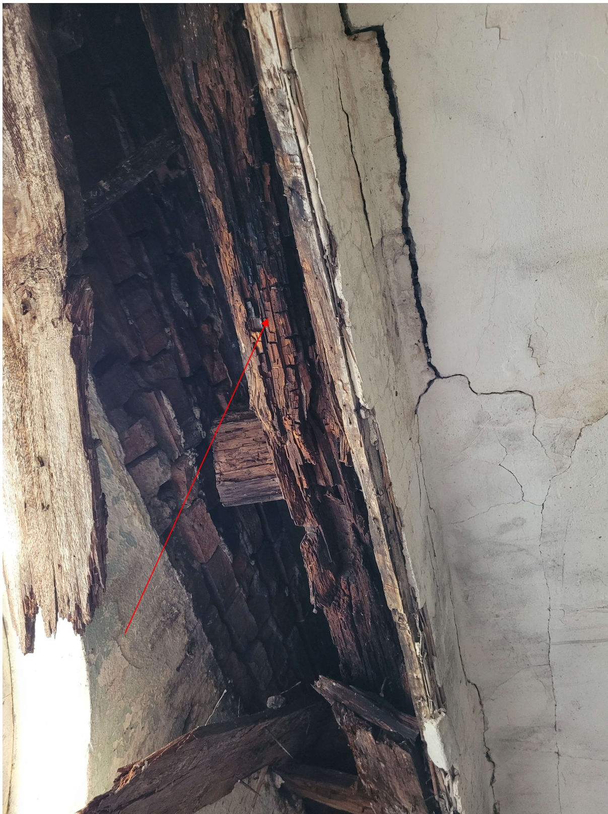
FOT 5 Uszkodzona płatew 16x20cm
