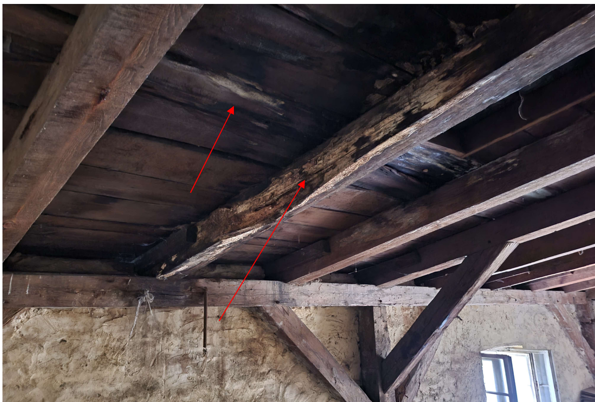
FOT 2 Uszkodzona krokiew 12,5x14cm oraz deskowanie
