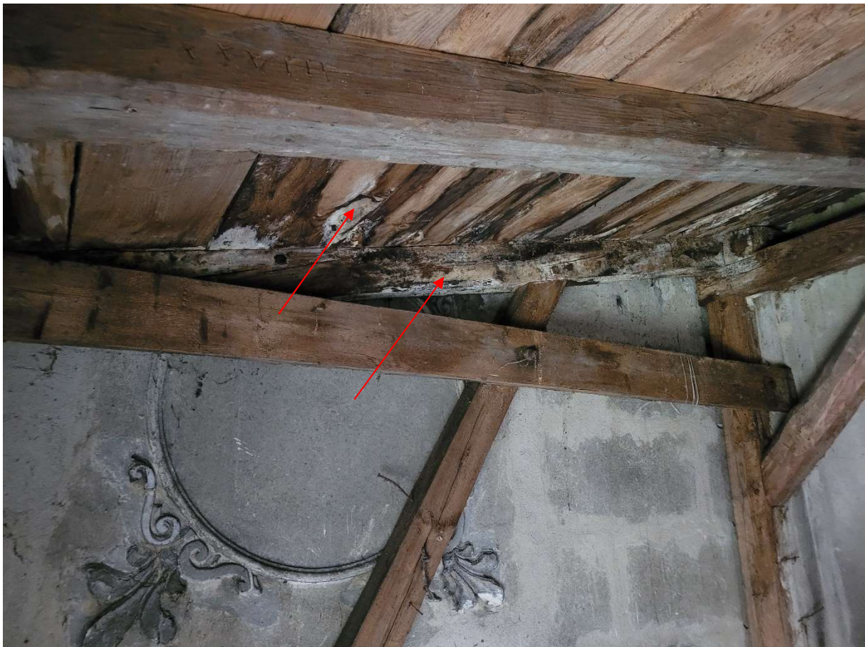
FOT 1 Uszkodzona krokiew 12,5x14cm oraz deskowanie
