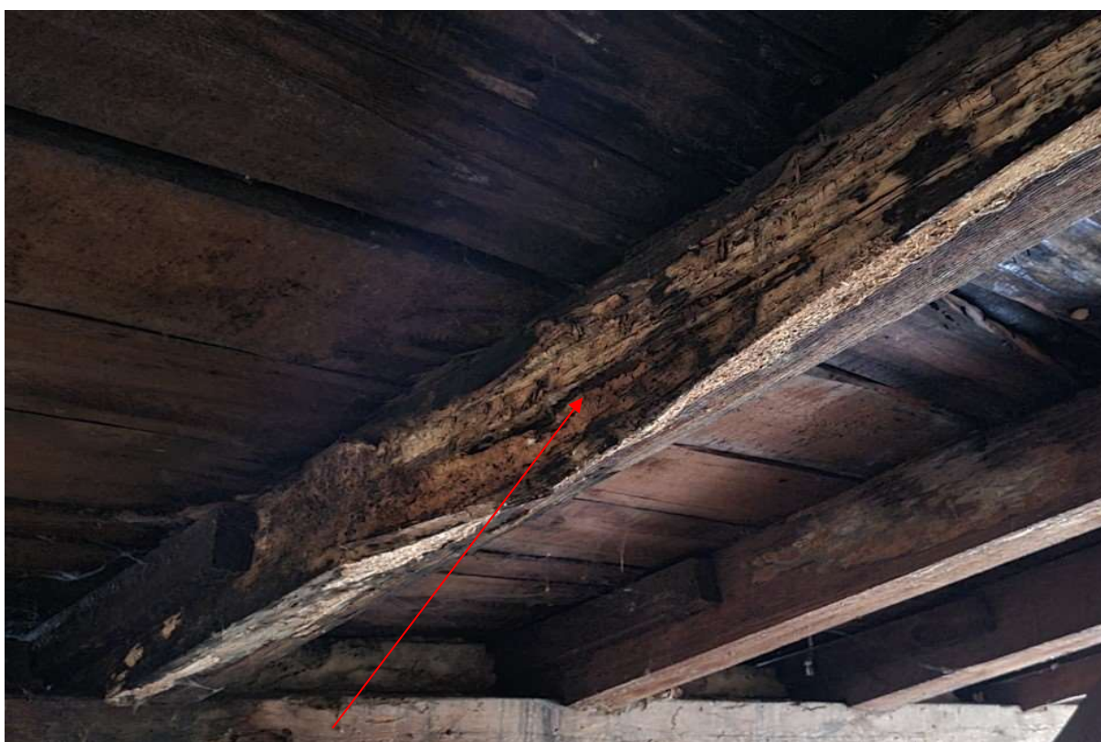
FOT 3 Uszkodzona krokiew 12,5x14cm oraz deskowanie
